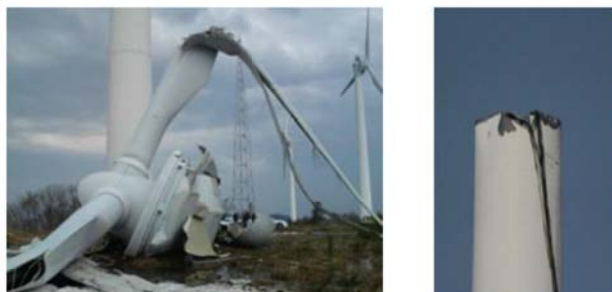
(a) 落下したロータ (b) 破断したタワー
