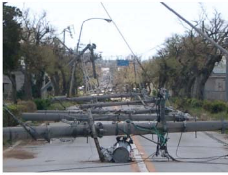
図-1 被災した配電用電柱
